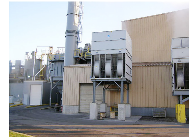
クローズドループ水冷システム
