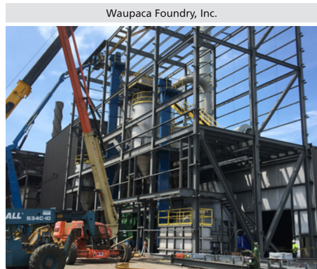
Plant5に導入した砂再生処理装置
