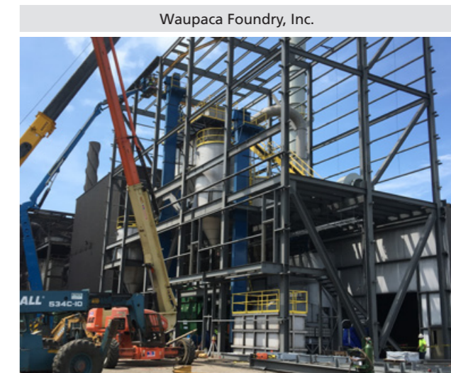
Plant5に導入した砂再生処理装置
