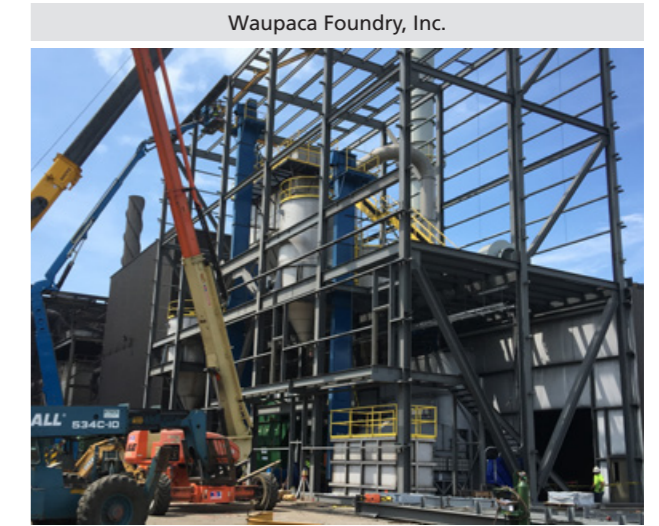
Plant5に導入した砂再生処理装置
