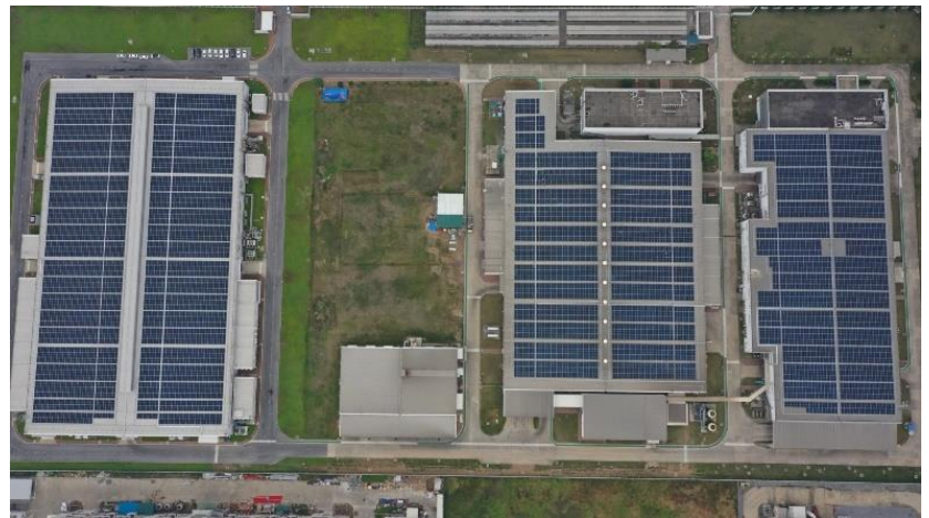
プロテリアル・ベトナム 太陽光発電設備
