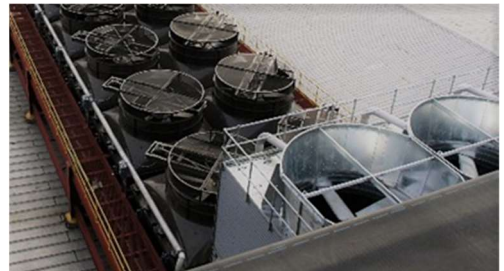
廃熱回収システム装置
