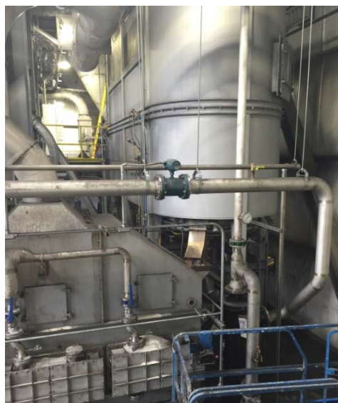
Plant 5 に導入した砂再生処理装置
