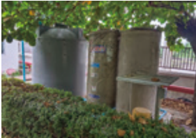
雨水リサイクル水の貯蔵用タンク
