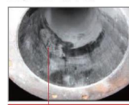
溶損・摩耗大
