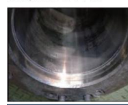
溶損なし、軽微な摩耗のみ
